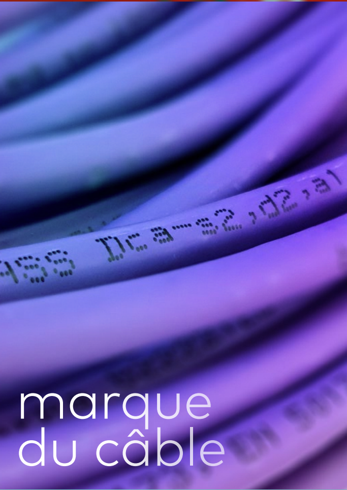
étiquette du câble
